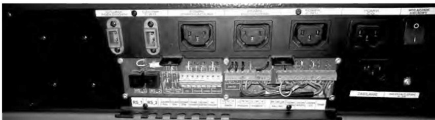
Obrázek 2 Svorkovnice pro napájení řídicích zařízení
